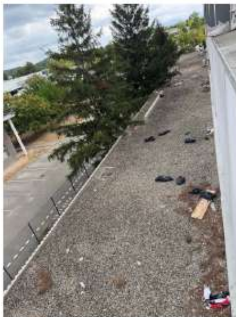
Photographie prise le 20 août 2026 – constat de déchets sur la toiture
